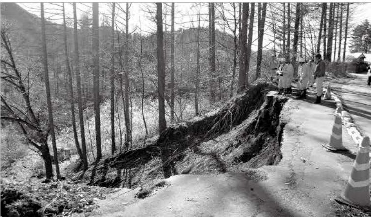
町道市の沢親沢線 親沢上崩落現場
