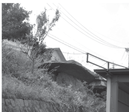
新田小海原線 崩落現場
