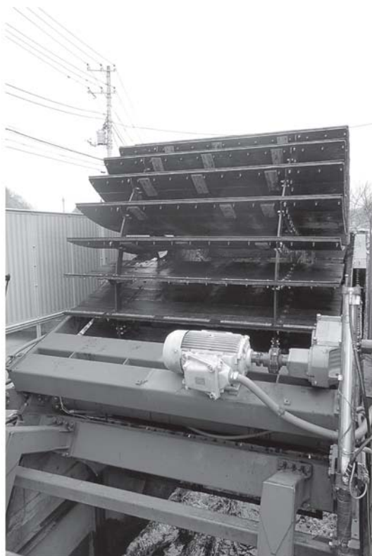
都留市水力発電施設
