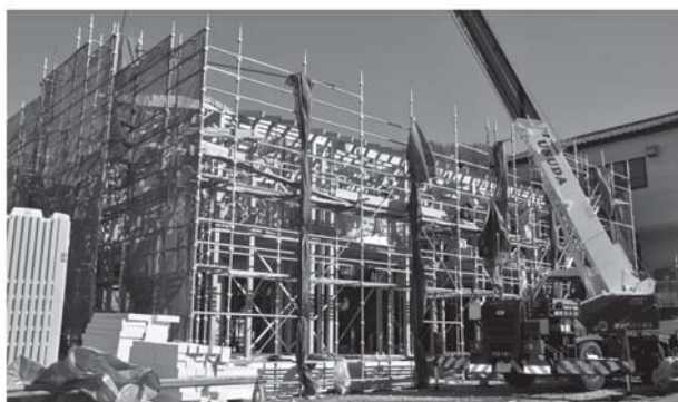
完成に向けて工事が進む土村栄町定住者向け町営住宅
