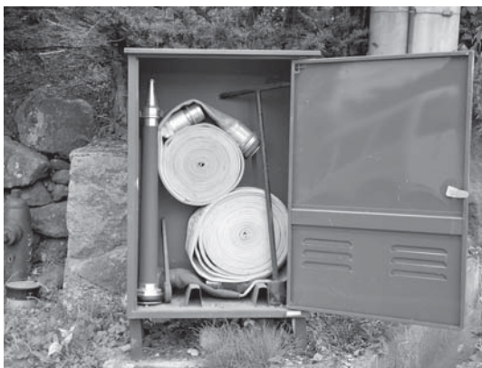
町内に設置されている消火栓・器具箱
