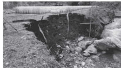
親沢地籍 水田畦畔崩落
