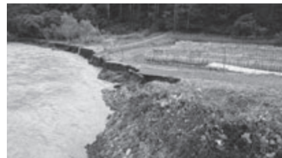
大州 相木川崩落
