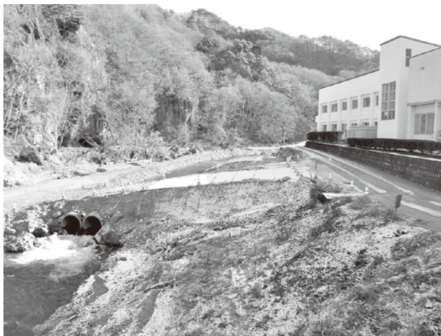
災害復旧中の小海小学校裏相木川
