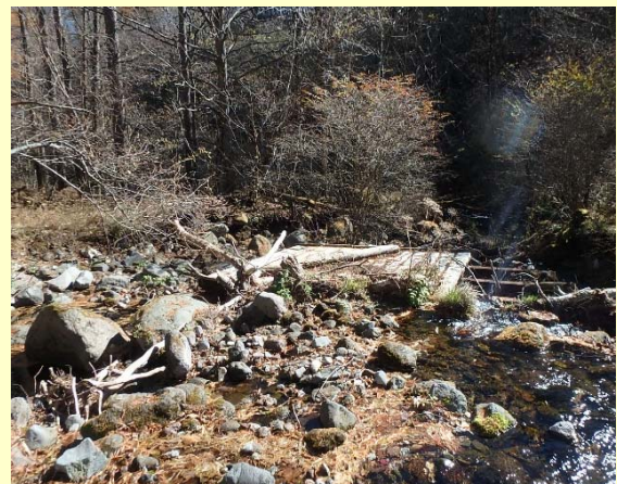
健全度 IV : 参考写真(橋梁流出)
