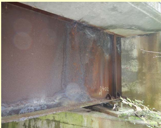
健全度 III : 島沢2号橋(主桁腐食)
