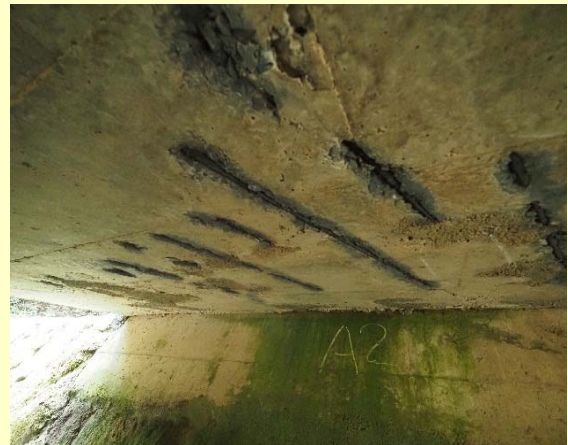
健全度 II : 日陰2号橋(鉄筋露出)
